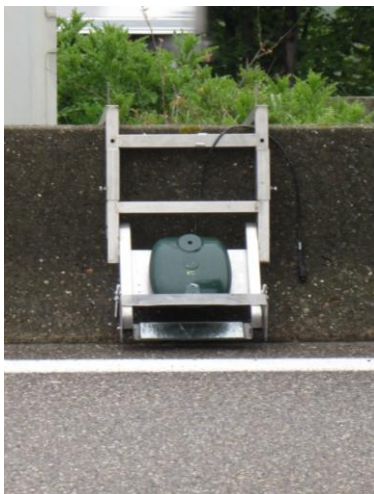
Foto 3: Installatie aan overkant van weg (bevestigd aan New Jersey) die infraroodstralen terugzendt
